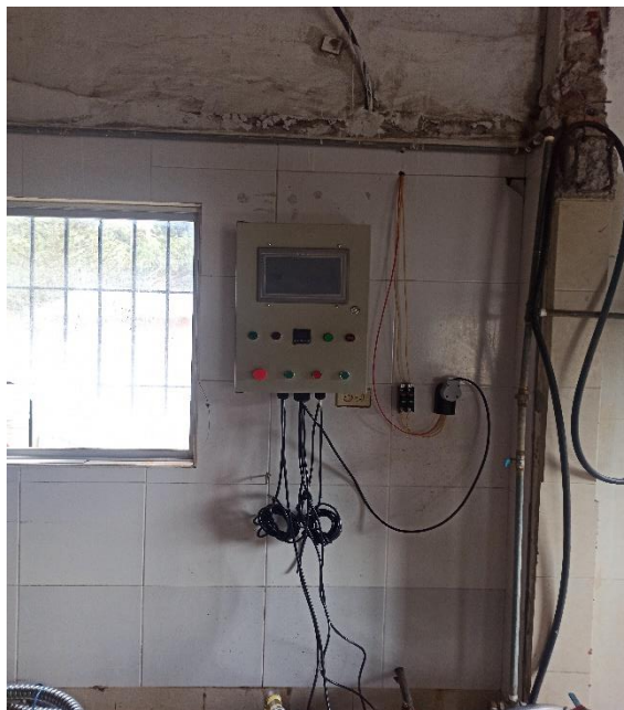
Empotrado del tablero de control
