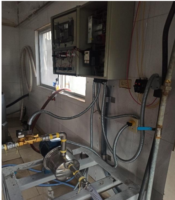
Cableado de electroválvulas, sensores, bomba y motor utilizando de protección tubo bx.
