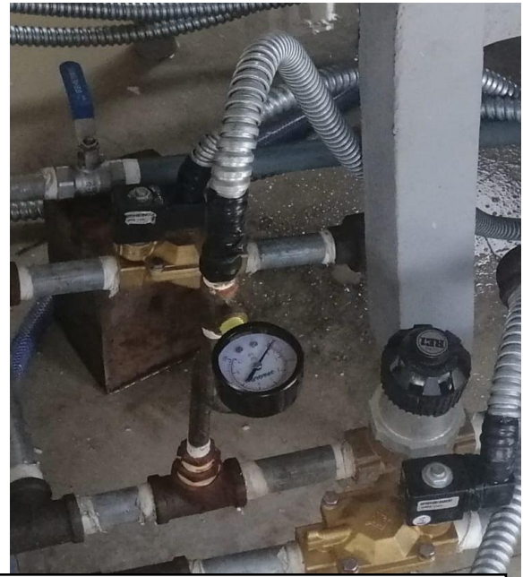
Instalación del sensor de presión P1A y manómetro
