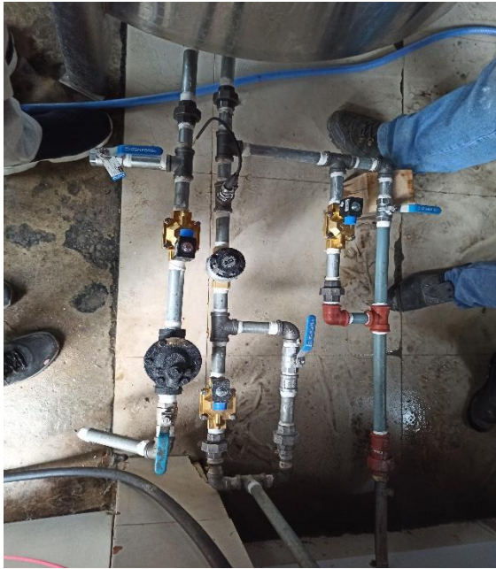
Instalación de las electroválvulas, válvula reductora de presión y trampa de vapor a la olla pasteurizadora.
