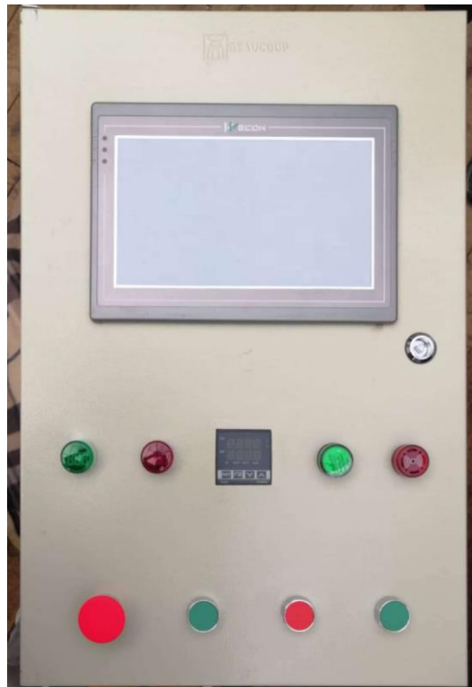
Figura 32-3: Puerta del gabinete eléctrico
