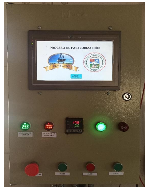
Prueba de alimentación del tablero de control
