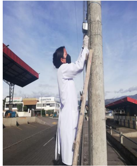
Colocación de muestreadores pasivos (P20) en las instalaciones del Mercado.
