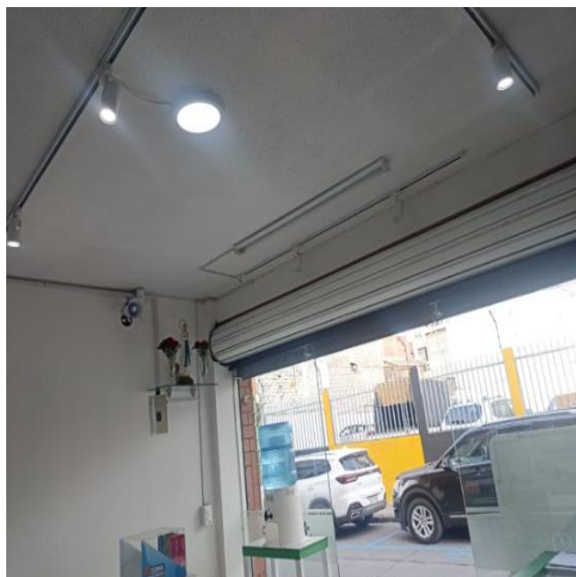
Ilustración 4-18: Sistema de iluminación
