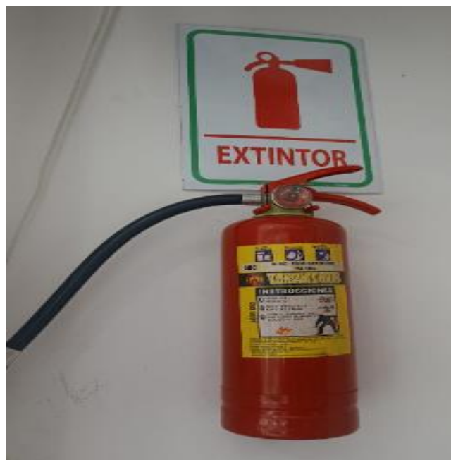
Ilustración 4-31: Ubicación del extintor de incendios
