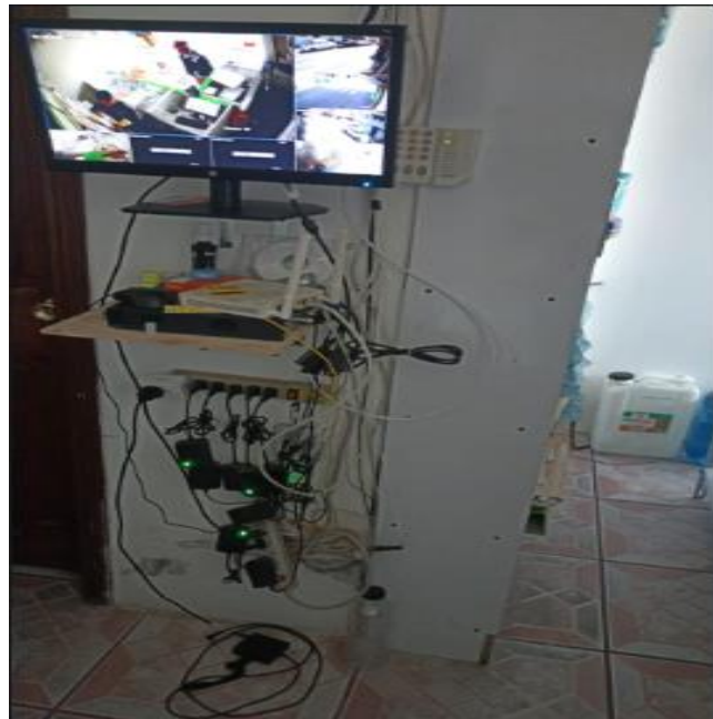
Ilustración 4-4: Cables sueltos en la farmacia
