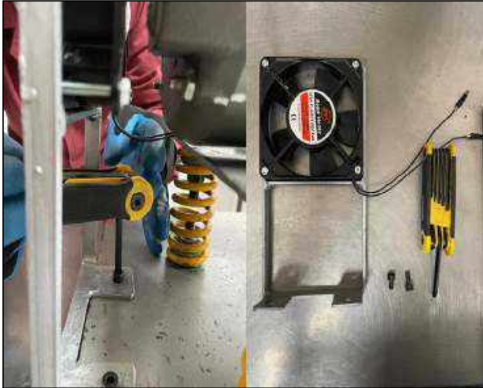
Ilustración 6-4: Desmontaje del ventilador de la placa base inferior
