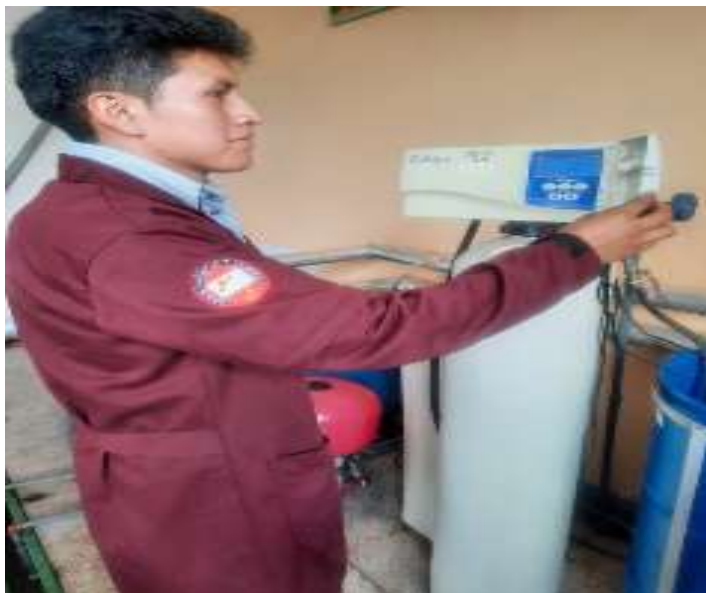
Ilustración 4-1: Ajustes del ablandador de agua del caldero
