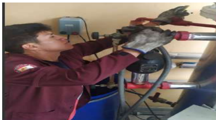
Ilustración 4-7: Válvula de globo de la caldera abierta
