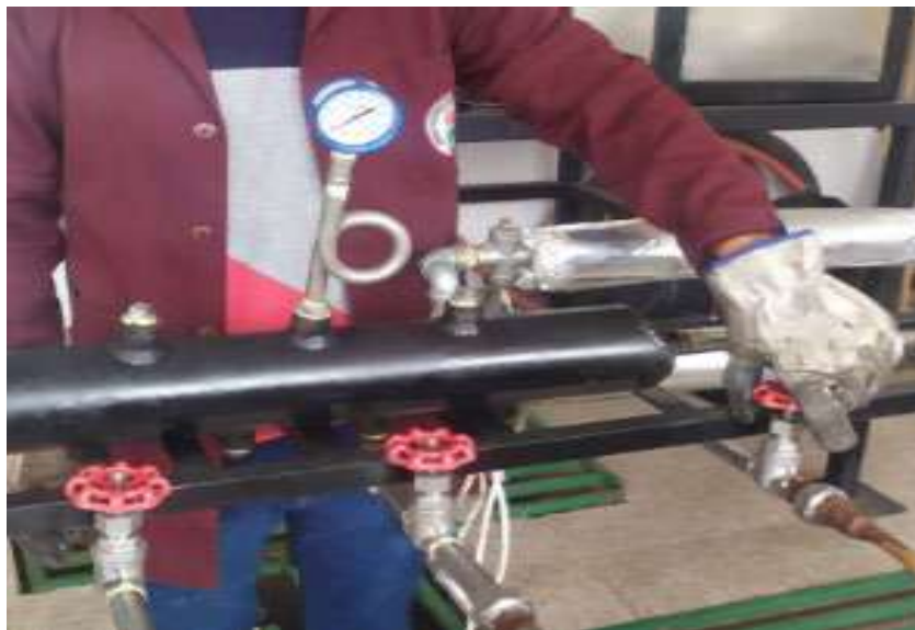
Ilustración 4-27: Válvula de compuerta del tramo 1,3 y 4 cerradas
