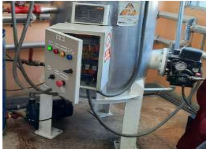
Ilustración 4-4: Tablero de control de la caldera
