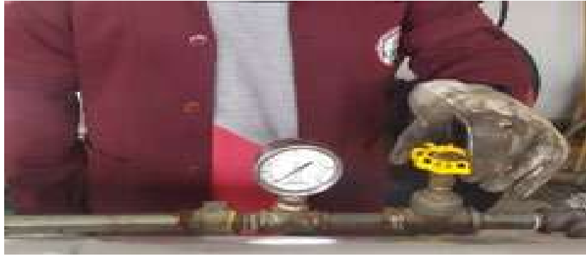
Ilustración 4-20: Válvula de compuerta de entrada del manifold
