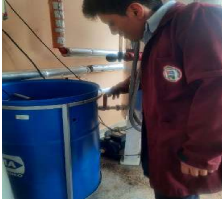
Ilustración 4-2: Revisión el nivel del tanque de agua
