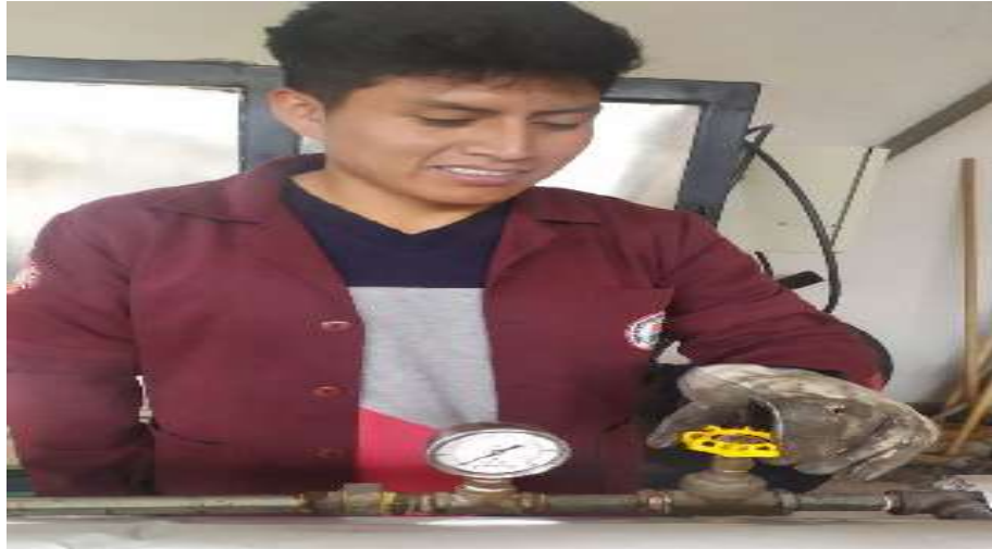
Ilustración 4-8: Válvula de compuerta de entrada de vapor al manifold
