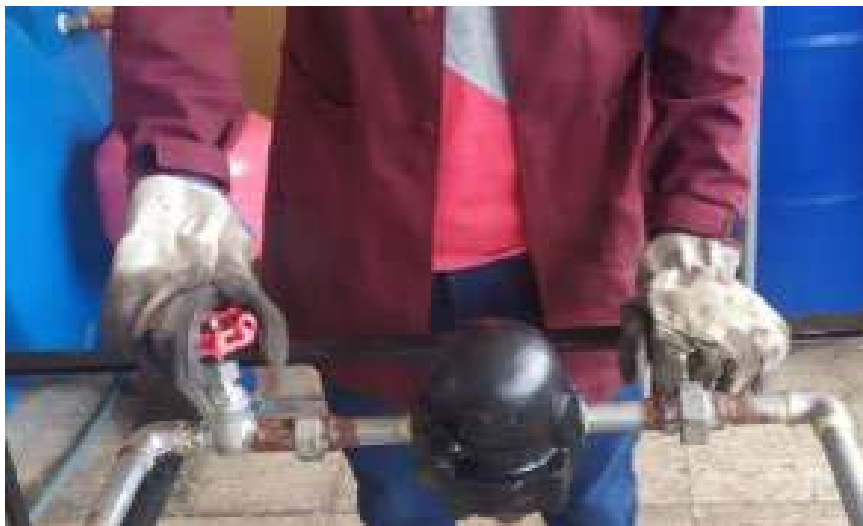
Ilustración 4-15: Válvula de compuerta del tramo 1,3 y 4 cerradas
