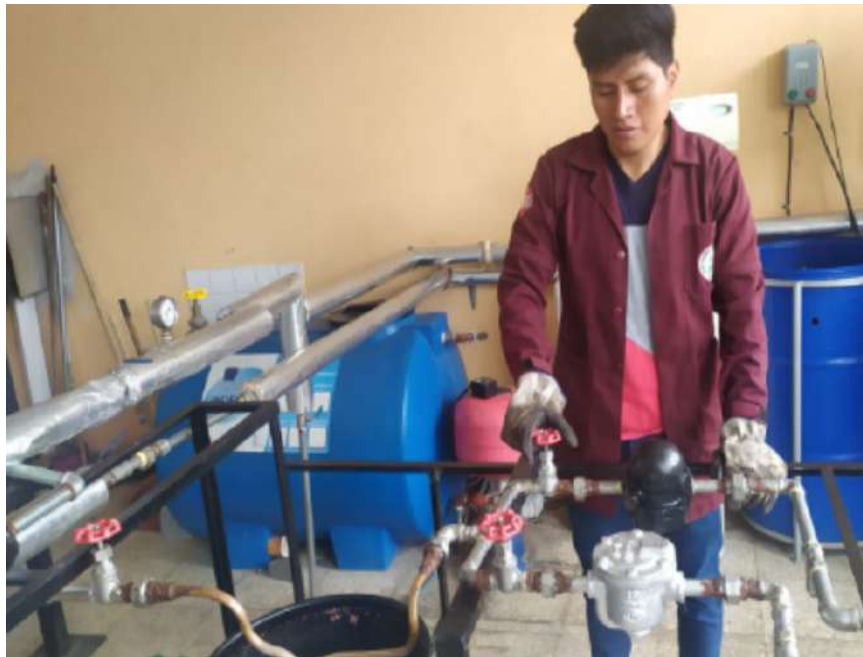
Ilustración 4-10: Válvula de compuerta del tramo 1 abierta
