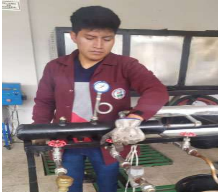
Ilustración 4-22: Válvula de compuerta del tramo 3 abierta
