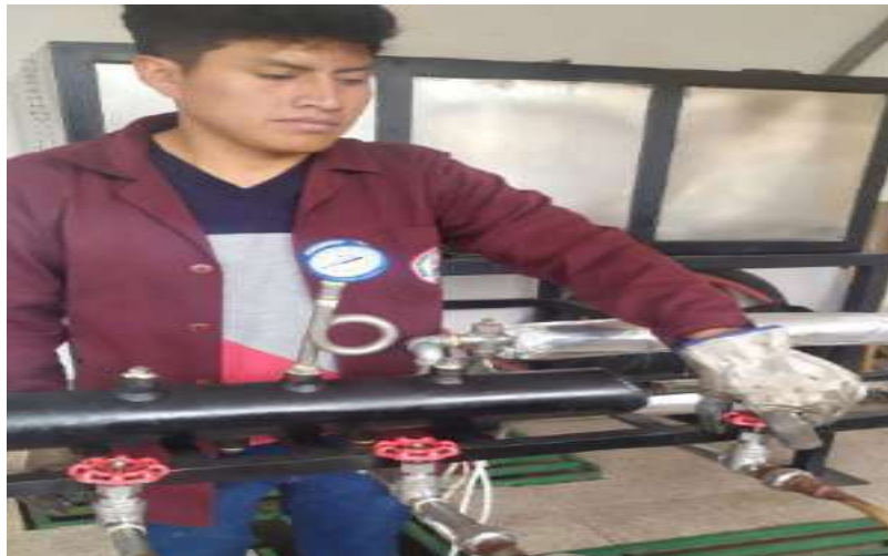
Ilustración 4-21: Válvula de compuerta del tramo 1 y 4 cerradas
