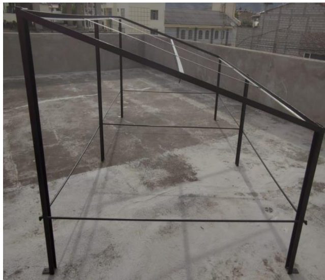
Figura 18-2: Estructura de los paneles solares Realizado por: Reyes, Paulo; 2021
