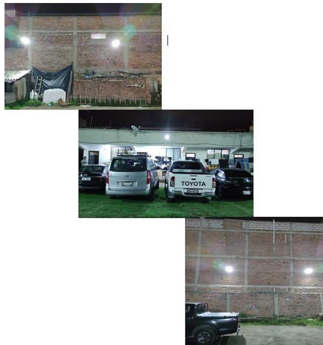
Figura 6-3: Reflectores ubicados en el parqueadero Realizado por: Reyes, Paulo; 2021
