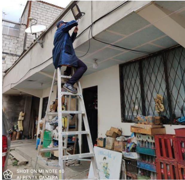
Figura 21-2: Conexión de los reflectores Realizado por: Reyes, Paulo; 2021
