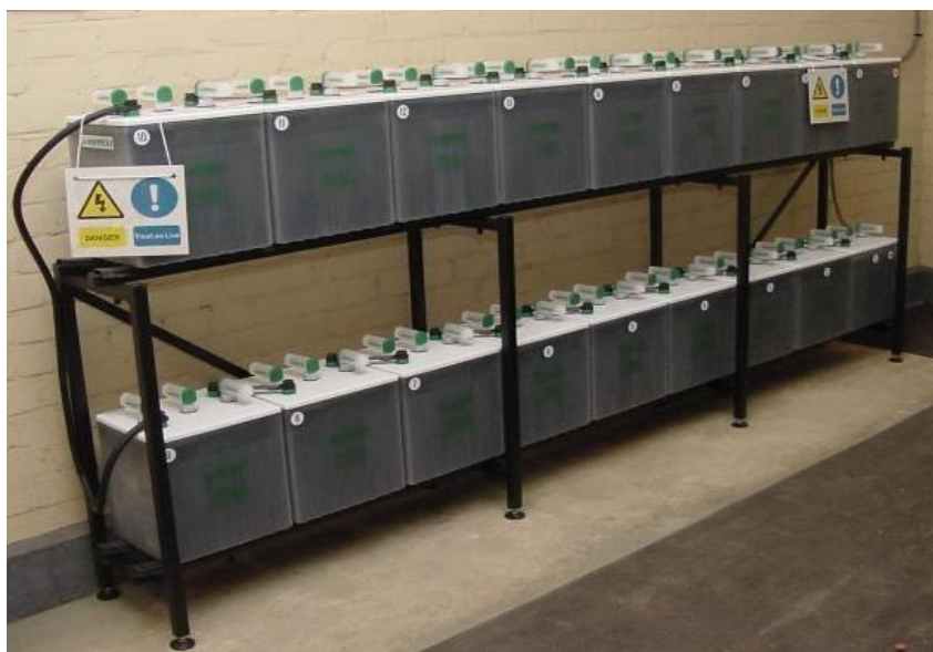
Figura 21-1: Banco de baterías
