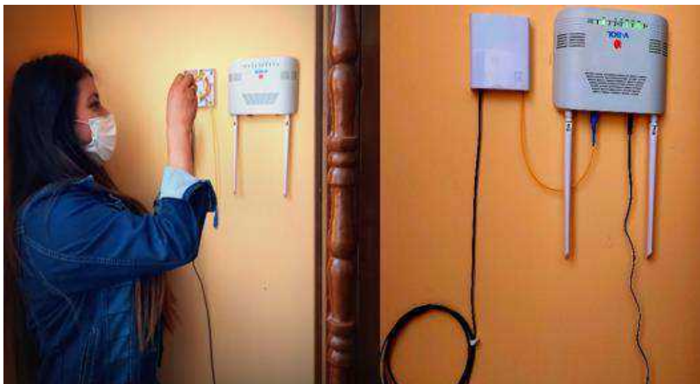
Figura 32: Instalación de la roseta y ONT
