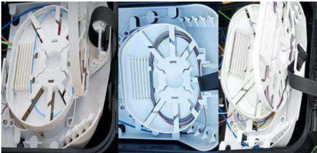
Figura 23: Colocación de hilos de fibra y splitter en las bandejas de la NAP.
