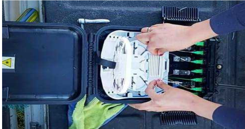
Figura 26: Colocación del splitter 1:8 en la bandeja de la NAP
