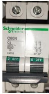
Interrupor de la bomba de llenado
