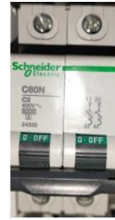
Interrupor de control
