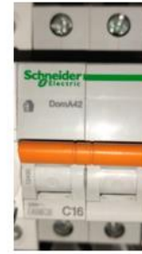
Interrupor de la bomba de recirculación
