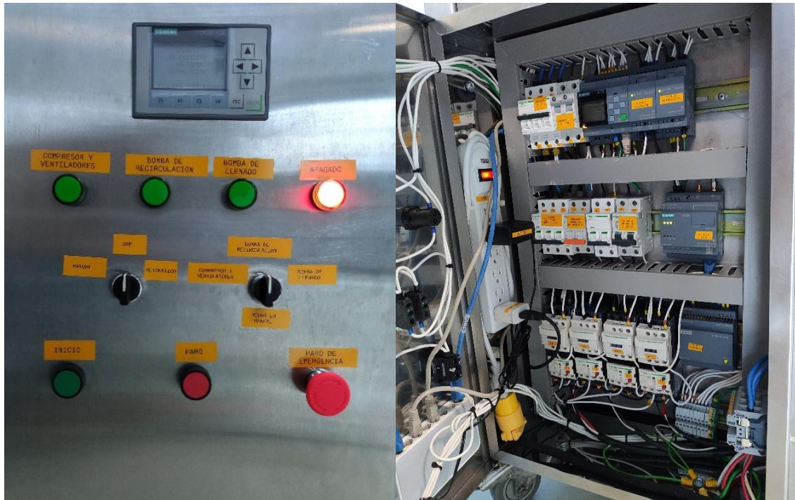
Figura 26-2: Tablero Eléctrico de control
