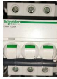
Interrupor del compresor y ventiladores
