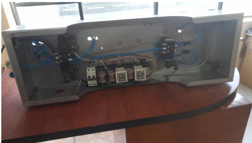
ANEXO 26-D. Sistema control electroneumático ensamblado al 100%
