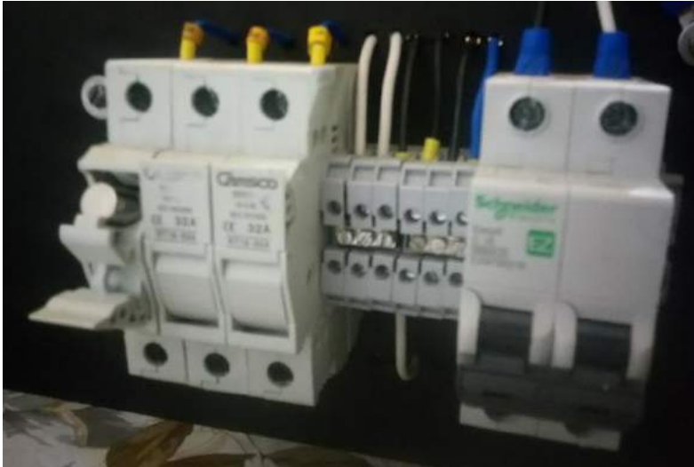
Figura 63: Breaker y borneras del alimentador y fusibles del circuito inversor.
