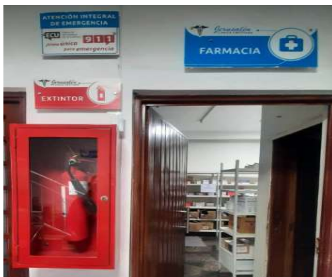
Ilustración 9-4: Extintor de incendios en la farmacia
