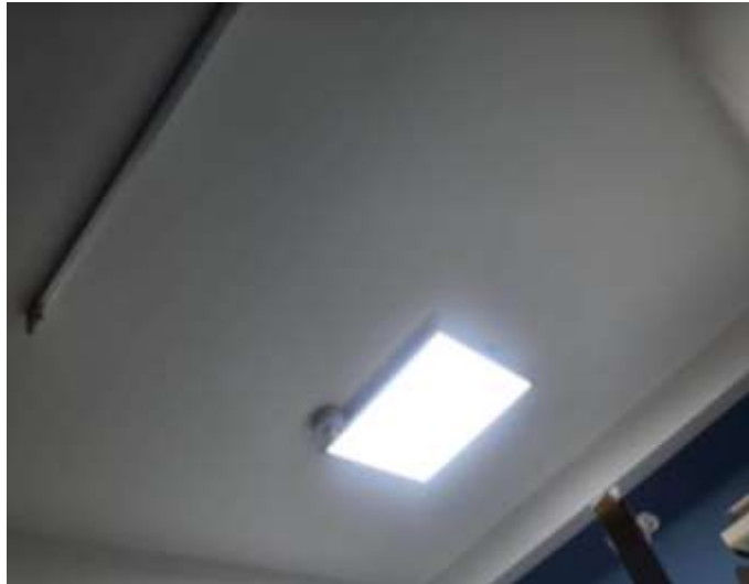
Ilustración 4-4: Adecuado sistema de iluminación
