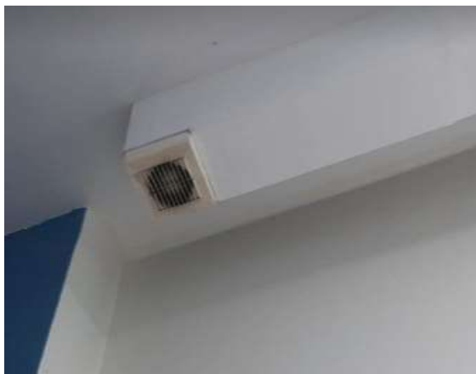
Ilustración 5-4: Ventilación en el área de farmacia
