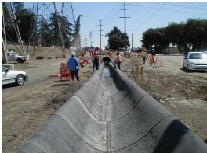
Ilustración 2-10. Colapso de tuberías por acción de depresiones
