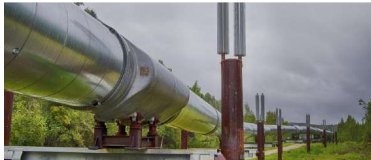
Ilustración 2-15. Fallas causadas por vibraciones en sistemas de tuberías
