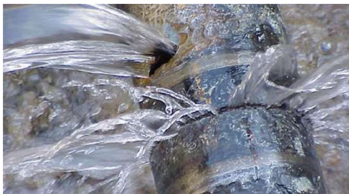
Ilustración 2-9. Fractura en tuberías por acción de sobrepresiones
