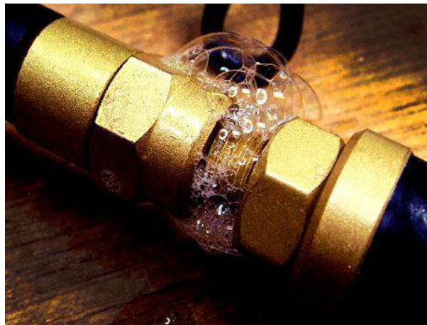
Ilustración 2-12. Pérdida de estanqueidad en conector de tubería detectable por burbujas
