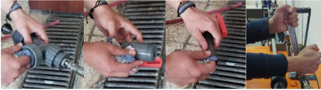
Ilustración 3-9. Mantenimiento de las válvulas del banco de pruebas
