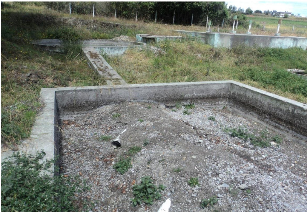
Filtro de arena
