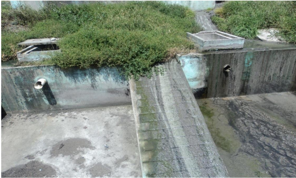
Lecho de secado de Lodos
