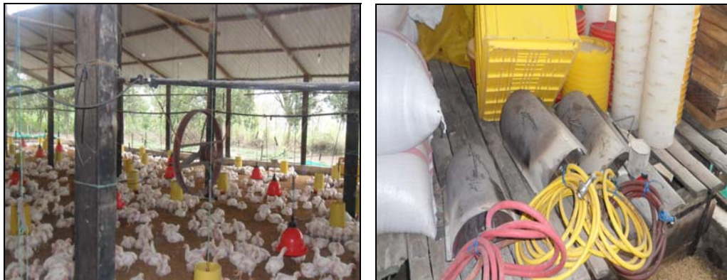
FOTOGRAFÍAS No. 6 - 7 SISTEMA DE ACONDICIONAMIENTO DE AIRE (VENTILADORES ELÉCTRICOS), SISTEMA DE ACONDICIONAMIENTO DE CALEFACCIÓN (CRIADORAS)
