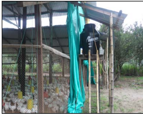
FOTOGRAFÍAS No. 16 – 17 - 18 TANQUES DE RESERVA DE AGUA PARA LOS GALPONES
