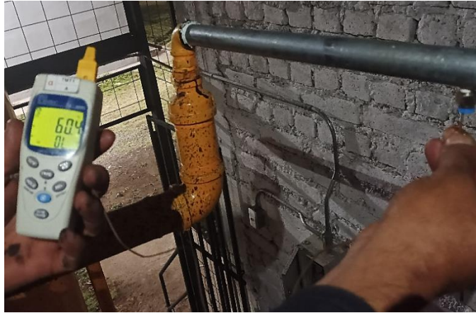
Ilustración 3-9: Toma de medida experimental de temperatura de gas pobre.
