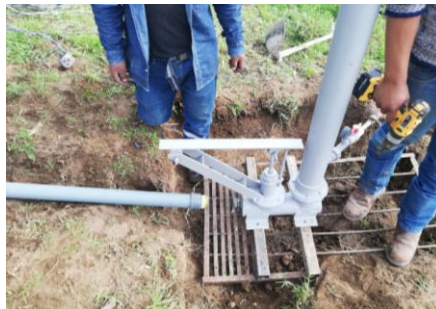
Figura 8-4: Tubería de alimentación e instalación total del ariete hidráulico.
