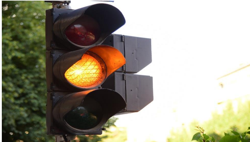
Ilustración 9-2: Semáforo con amarillo intermitente
