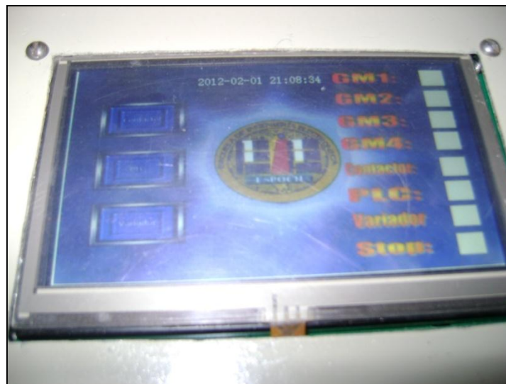
Figura IV. 60 Pantalla programada e instalada en el módulo de entrenamiento
