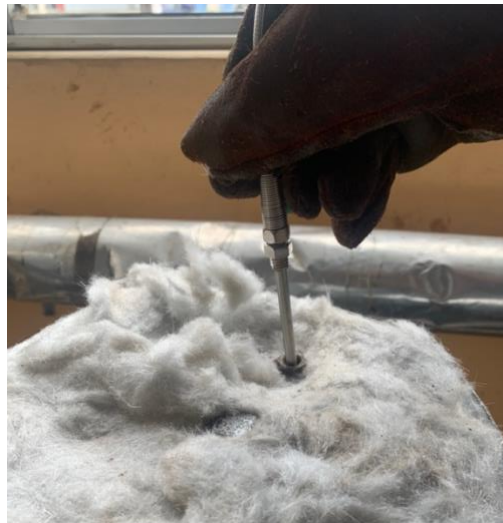
Ilustración 15-4: Colocación del PT100 en la cámara de expansión
