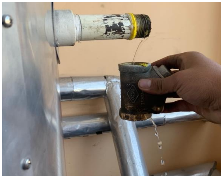
Ilustración 2-4: Prueba de funcionamiento de la válvula antirretorno del caldero
