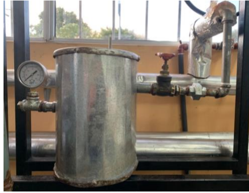
Ilustración 11-4: Manómetro y tubería instaladas previo a ser instalada la cañuela de lana de vidrio
