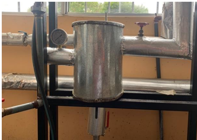
Ilustración 14-4: Tubería recubierta por cañuela de lana de vidrio
