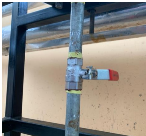
Ilustración 12-4: Válvula de bola en tubería de purga del calorímetro
