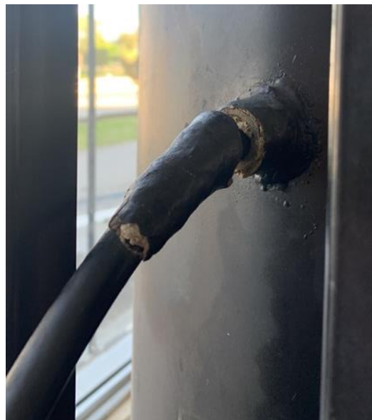
Ilustración 2-3: Estado de la manguera de la salida de diesel
