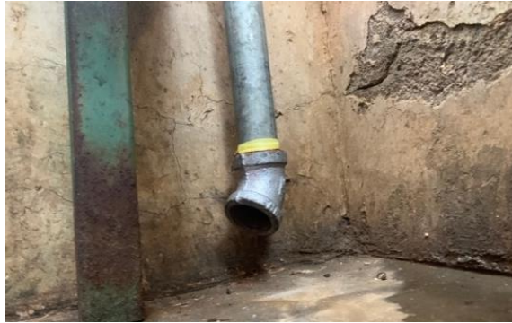
Ilustración 13-4: Codo de 45° en tubería de purga del calorímetro
