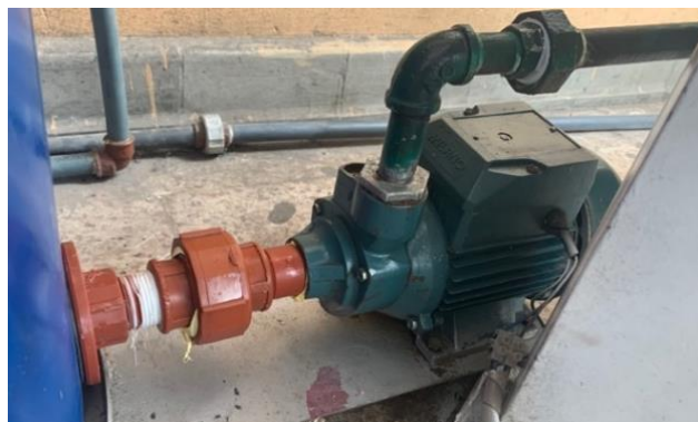
Ilustración 1-3: Electrobomba centrífuga antigua y tubería galvanizada de 0,5 pulgadas
