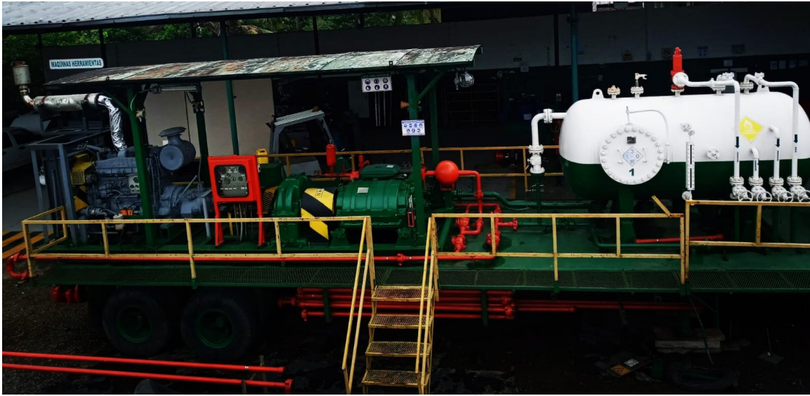
Ilustración 7-3: Bombas M.T.U. de la empresa TEAM S.A.
