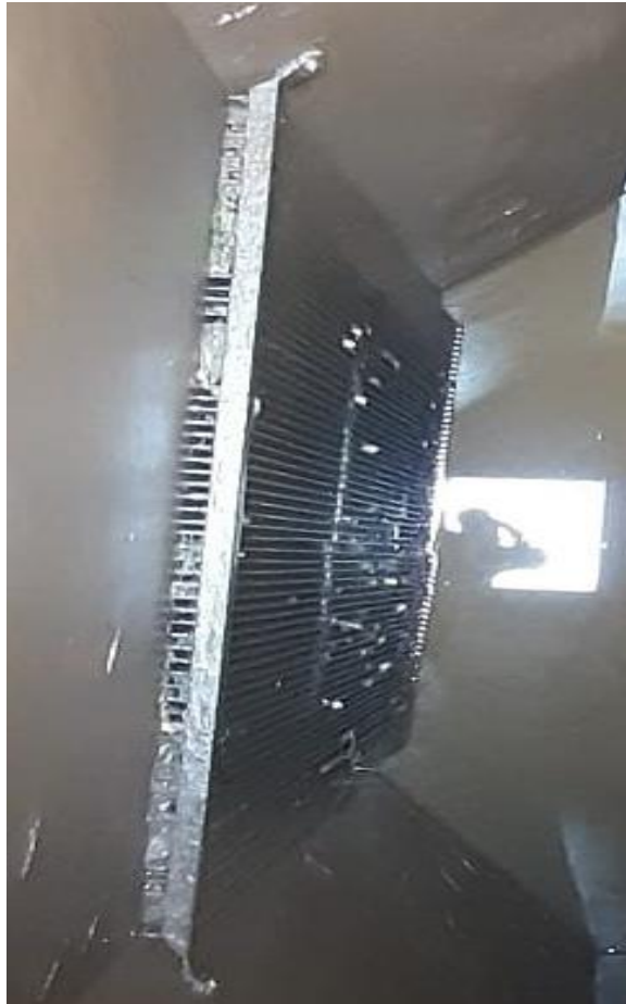
Ilustración 6-3: Rejilla de Limpieza del tanque rompe presiones
