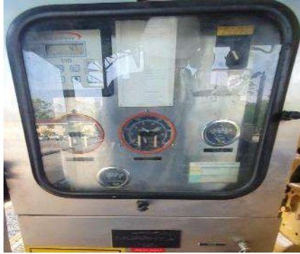
Ilustración 9-2: Tablero de control, MTU
