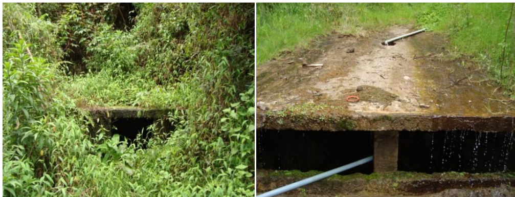
Figura 3. Cámara de captación de vertientes de Paylahuaico
