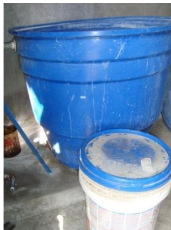
Figura 16. Tanque para mezclado, desinfección actual San Vicente de Lacas
