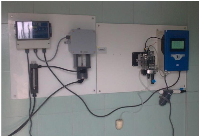
Figura 66. Válvula automática y analizador de cloro libre
