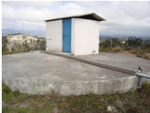
Figura 5. Tanque de reserva de la comunidad San Vicente de Lacas
