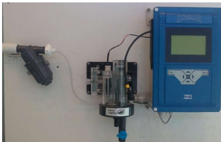
Figura 65. Analizador de cloro libre
