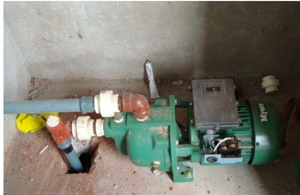
Figura 34. Bomba de refuerzo
