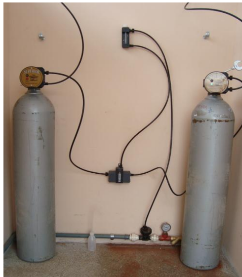
Figura 33. Equipo clorinador operado por vacío
