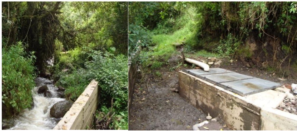
Figura 2. Captación de río Paylahuaico hacia caja reguladora de caudal
