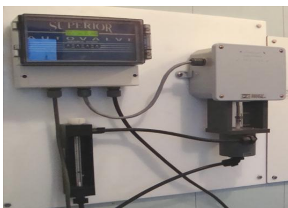
Figura 37. Válvula automática y controlador de cloro gas
