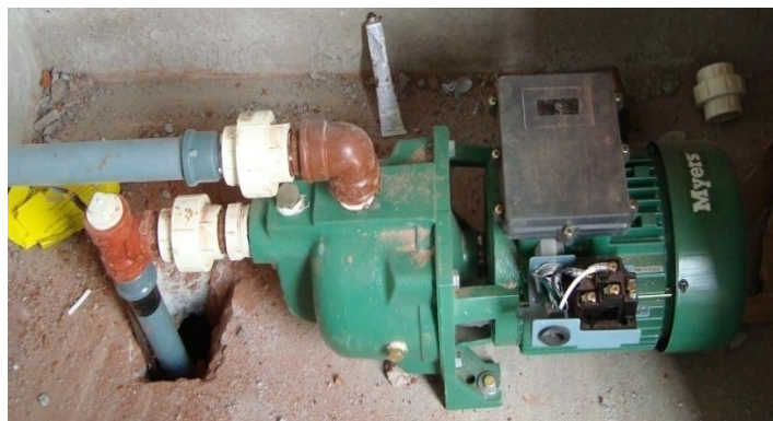
Figura 68. Bomba de apoyo
