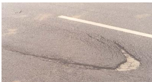
Ilustración 3-2: Grieta en forma de medialuna con presencia de ruptura
