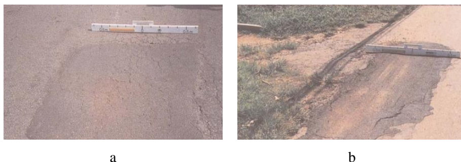
Ilustración 6-2: Parches (a) sobre y (b) debajo del nivel de una superficie asfáltica
