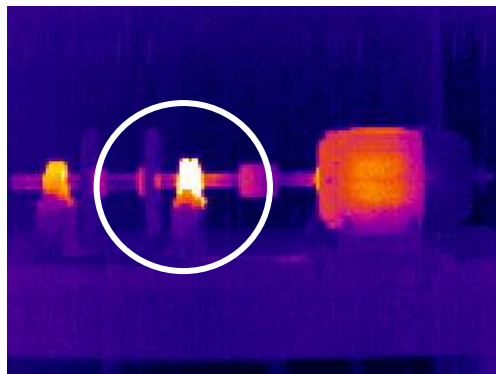
Figura 2-2: Termograma con fallo
