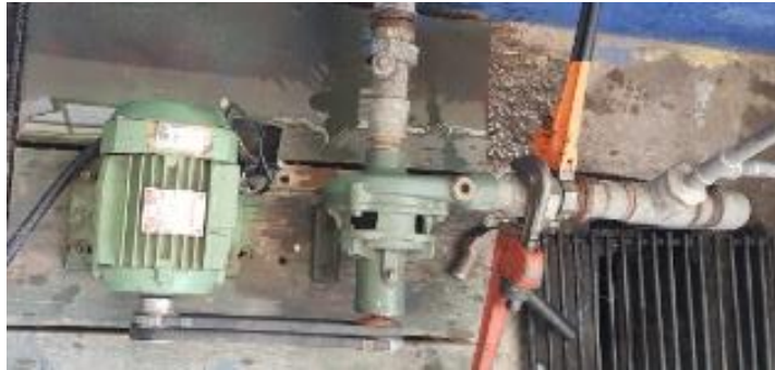
Figura 3-3: Motor eléctrico acoplado a la bomba de agua.
