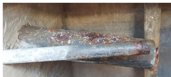
Figura 7-3: Corrosión en las tuberías de descarga de agua.
