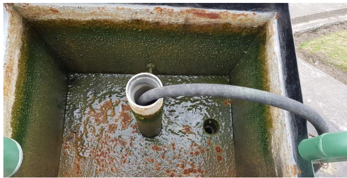
Figura 8-3: Tanque de reservorio de agua.
