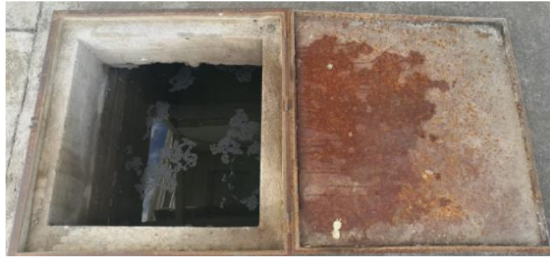
Figura 1-3: Cisterna del sistema de refrigeración.
