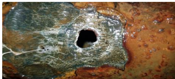
Figura 6-3: Picaduras en la línea de succión de agua de la cisterna.
