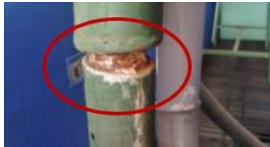
Figura 5-3: Fatiga en el acople de la tubería y el tanque de agua.
