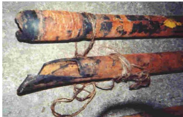
Figura 14-0: Tubería de revestimiento corroídas
