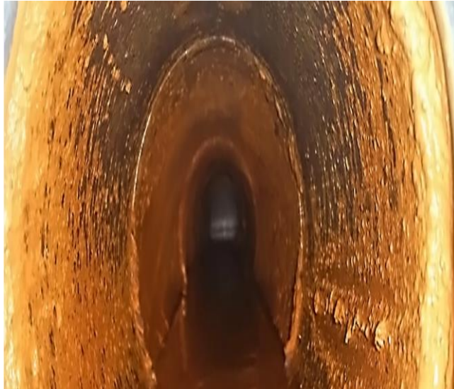
Figura 15-0: Corrosión por pitting
