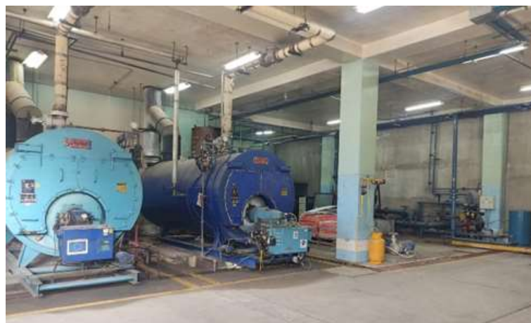
Figura 40-3: Cuarto de máquinas del DM
