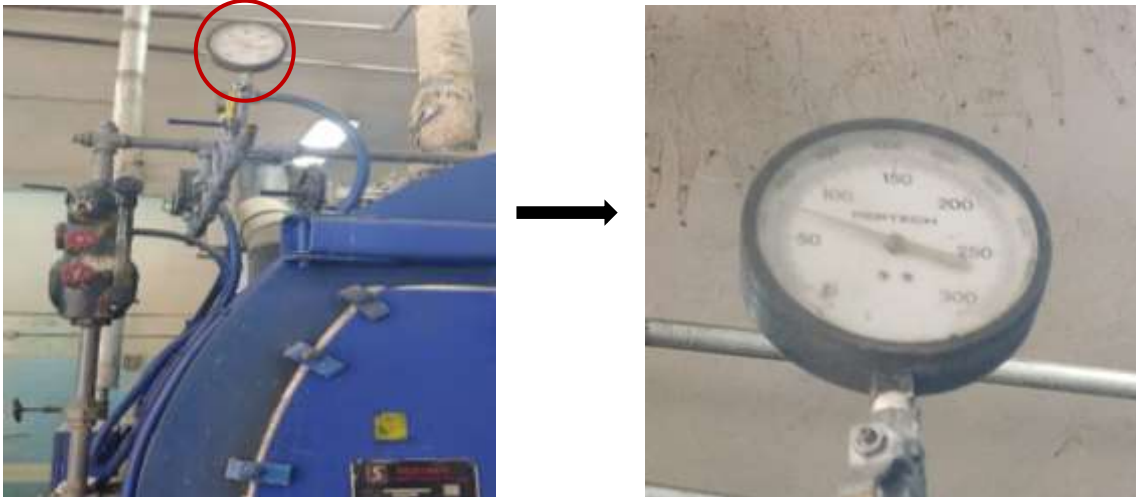
Figura 20-3: Manómetro indicador de presión ubicado en el caldero del HPGDR
