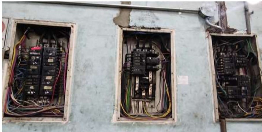
Figura 34-3: Tableros eléctricos sistema eléctrico fuerza del DM
