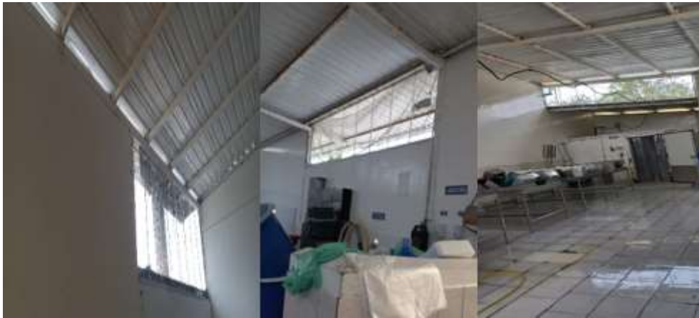
Imagen 7: aberturas en la planta que dificulta su limpieza y desinfección
