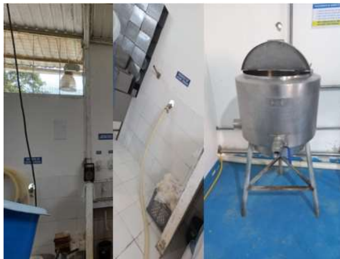
Imagen 2: orificios que no ofrecen protección contra materias extrañas
