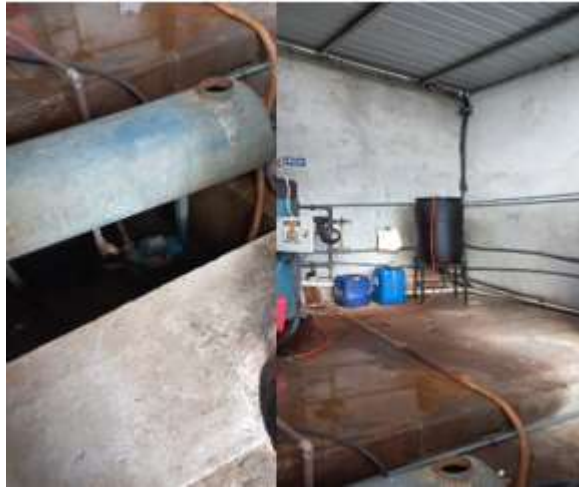
Imagen 1: grietas en donde existen plagas
