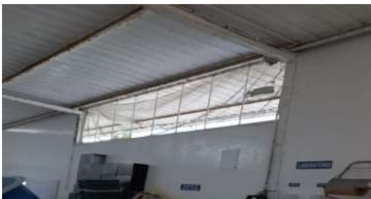
Imagen 8: aberturas con un sistema de protección dañado
