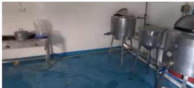
Imagen 5: área de producción de yogurt no cuenta con unión cóncava entre piso y pared
