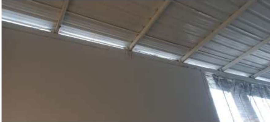
Imagen 6: no existe un ángulo en las terminaciones pared – techo.
