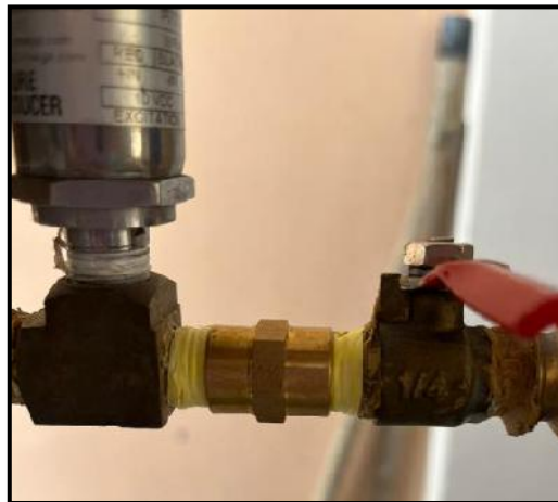
Ilustración 78-4: Purgador sin fugas.
