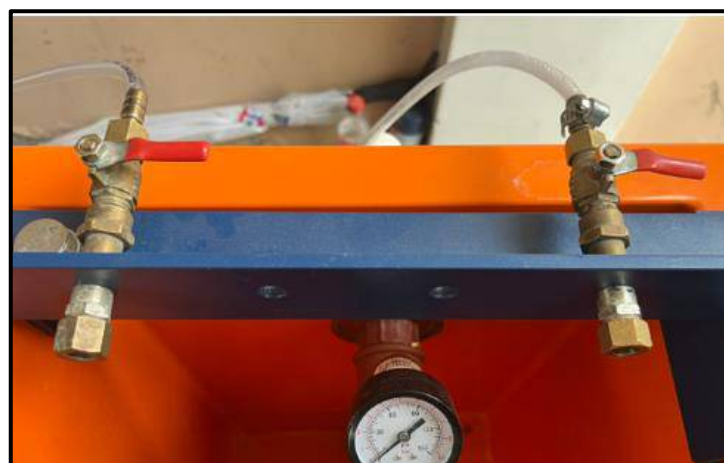
Ilustración 76-4: Manifold con válvulas de cebado del sistema
