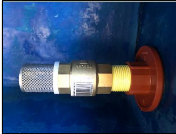
Ilustración 69-4: Estado actual de la válvula de pie
