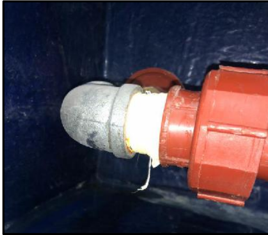
Ilustración 45-3: Empaques en mal estado
