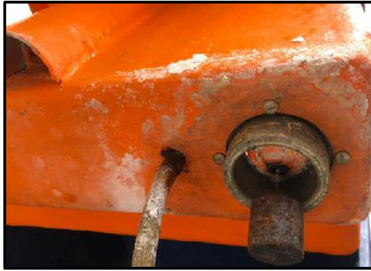
Ilustración 40-3: Falla de sellado del tanque principal
