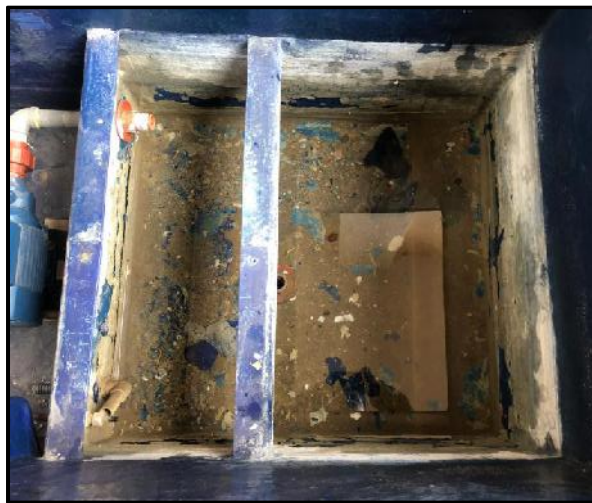
Ilustración 39-3: Estado inicial del tanque secundario
