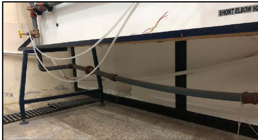
Ilustración 55-3: Tuberías sin soportes
