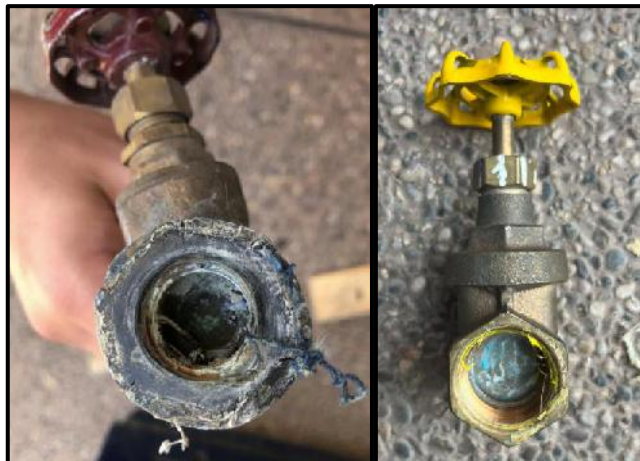
Ilustración 46-3: Válvulas de compuerta atascadas
