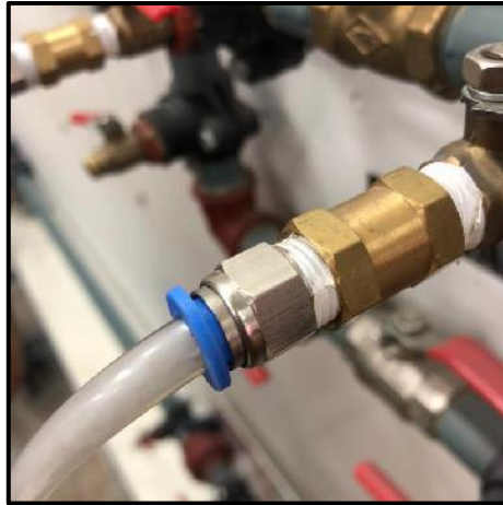
Ilustración 47-3: Acoples en mal estado
