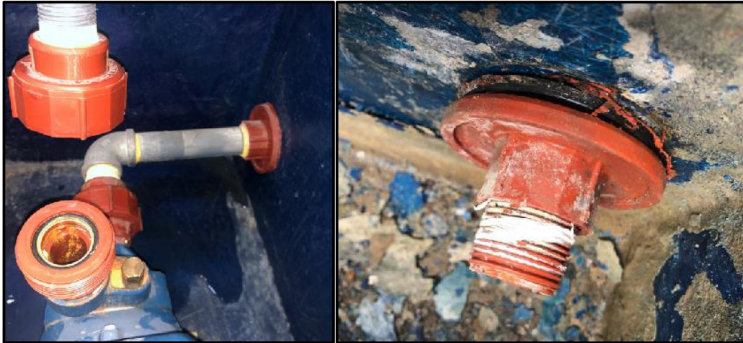
Ilustración 38-3: Fugas en salidas del tanque
