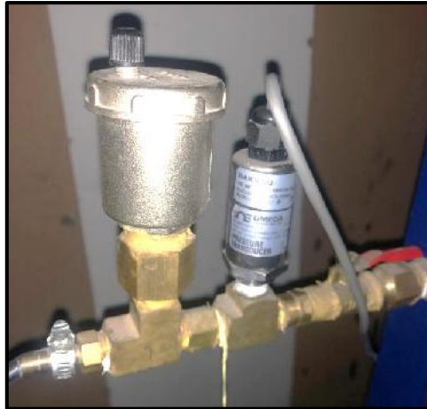
Ilustración 51-3: Purgador con fugas
