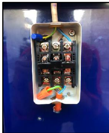
Ilustración 72-4: Cables correctamente aislados
