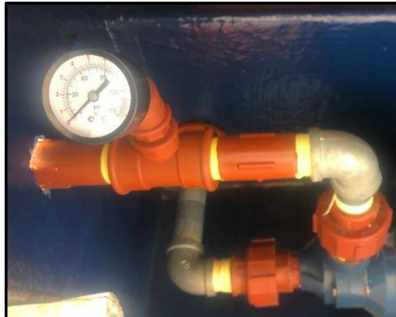
Ilustración 79-4: Manómetro en la salida de la bomba.
