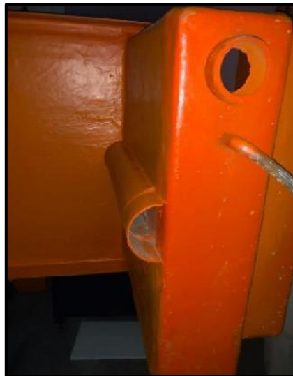
Ilustración 68-4: Tapa de tanque secundario y tanque principal
