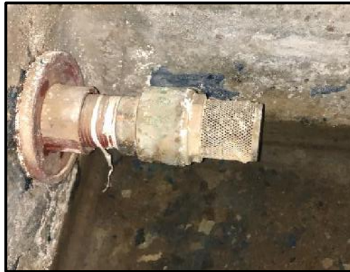
Ilustración 41-3: Estado inicial de la válvula de pie
