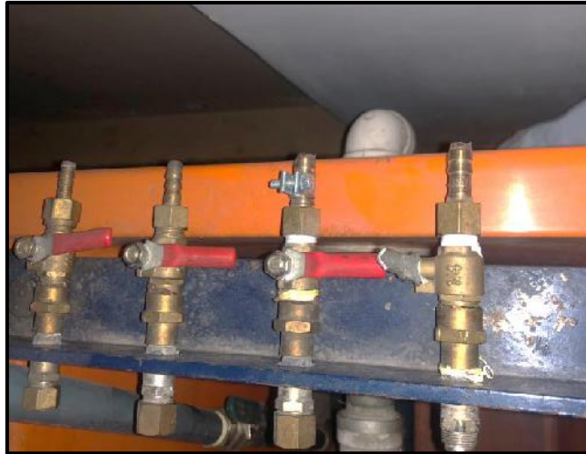
Ilustración 49-3: Mal estado de válvulas para cebado
