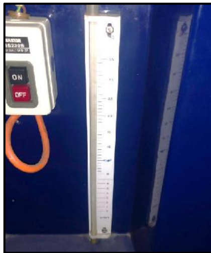
Ilustración 50-3: Medidor de volumen desconectado
