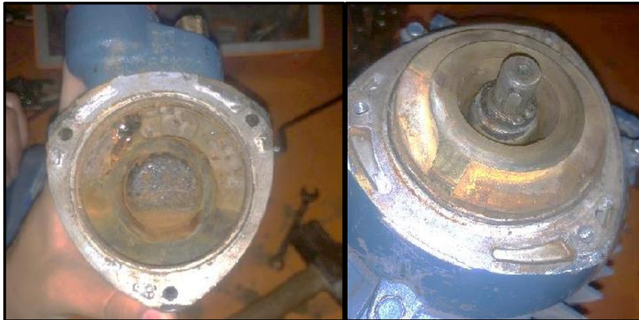
Ilustración 44-3: Rodete de la bomba atascado
