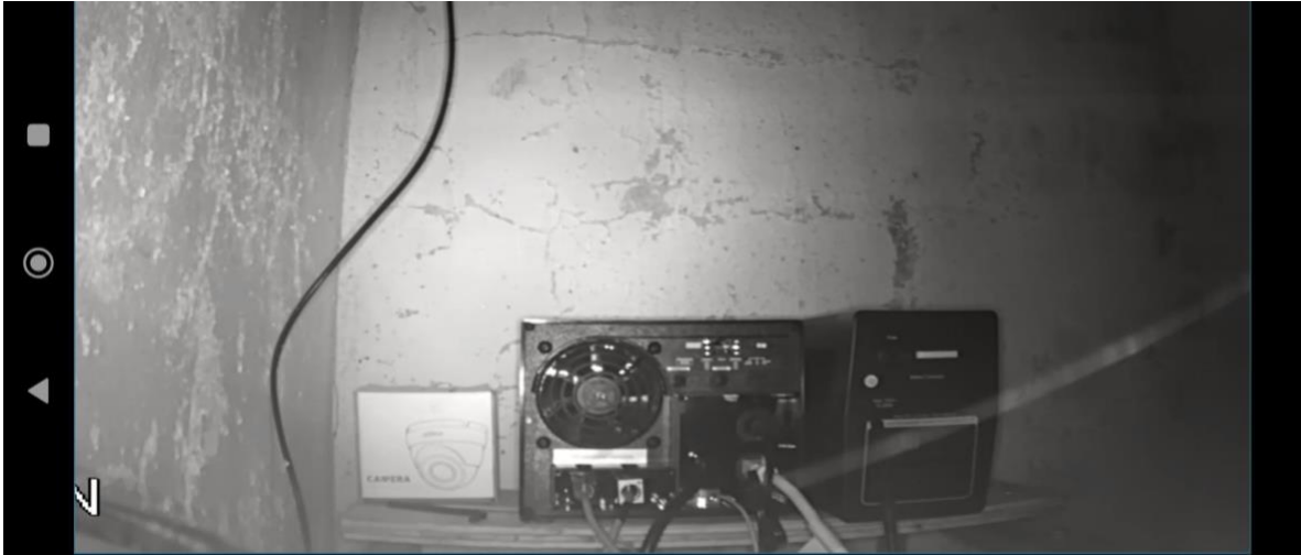
Figura 22-4: Sistema funcionando con baterías
