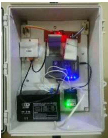
Figura 18-2. Implementación inicial dentro del gabinete.
