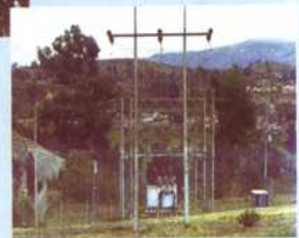
Subestación San Juan
