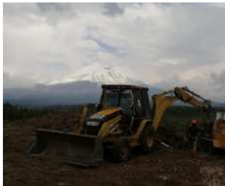
Figura 5-2. Cargadora retroexcavadora Caterpillar
