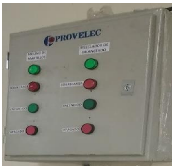
Figura 1-4: Implementación del tablero de control
