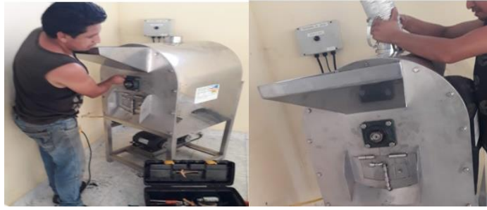
Figura 3-3: Baqueteo del quemador, tuberías e implementación de chimenea
