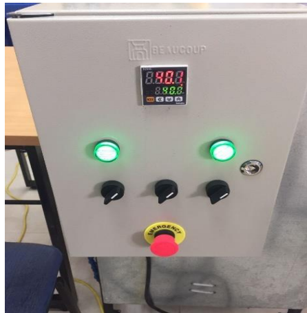
Figura 22-2: Tablero de control Realizado por: (Lema B., Toapanta K. 2022)
