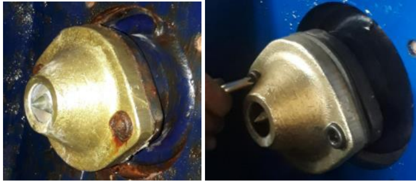
Figura 3-4: Comparación del estado del túnel de inyector
