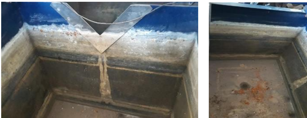
Figura 22-3: Tanque de agua corroído
