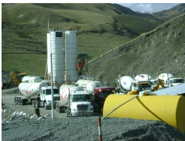
Figura 2.41. Planta de Hormigón.
