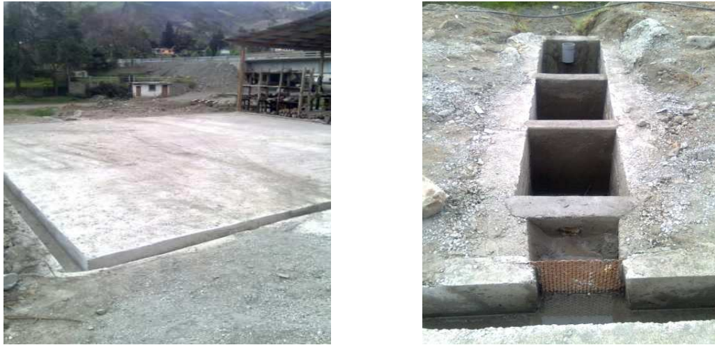
Figura 4.65. Plataforma y trampa de grasa taller mecánico.
