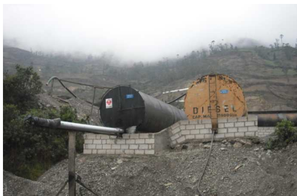
Figura 2.44. Tanques de AP3 y Diesel.
