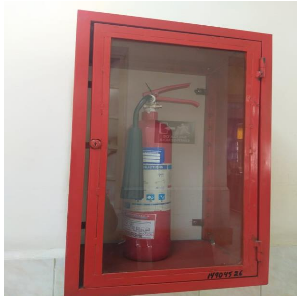
Figura 25-3: Extintor con acceso restringido
