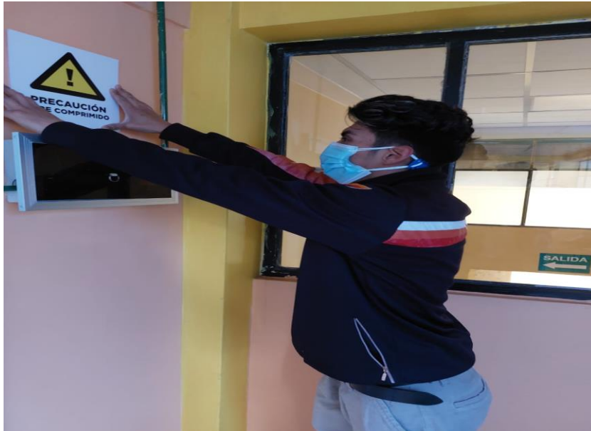
Figura 3-4: Implementación de señalética área de aire comprimido
