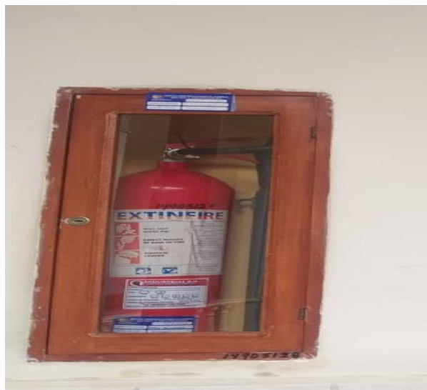
Figura 24-3: Extintor sin señalética
