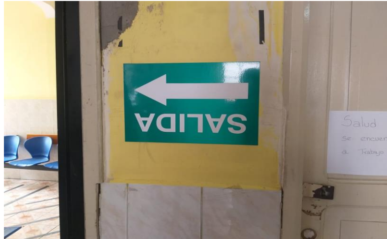
Figura 27-3: Señaléticas mal ubicadas
