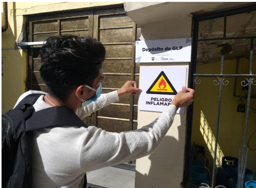
Figura 4-4: Implementación de señalética de peligro inflamable
