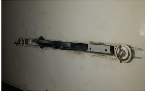
Figura 20-3: Vista exterior de la carcasa mariposas finales de carrera
