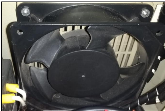
Figura 28-3: Vista ventilador del tablero
