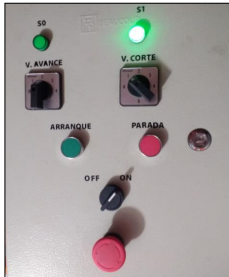
Figura 25-3: Vista frontal tablero de control
