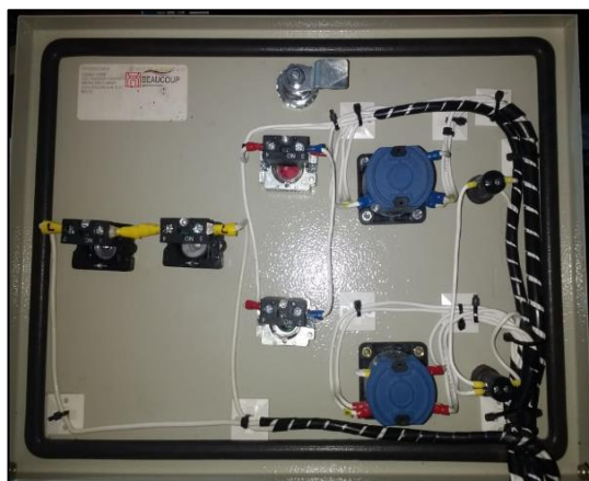
Figura 26-3: Vista interna tapa del tablero.
