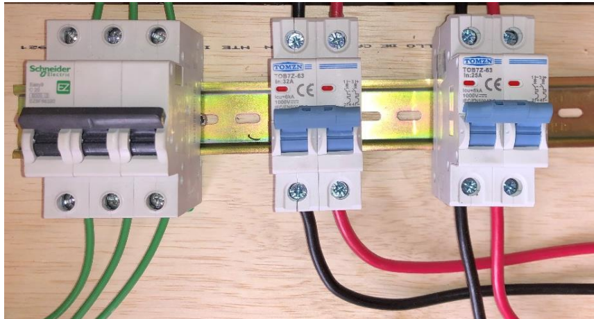
Figura 21-3: Relés de protección para la turbina, panel solar y baterías
