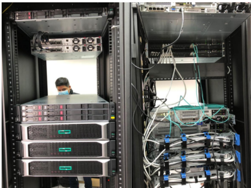
Figura 6-5. Montaje de equipos vista frontal y posterior Fuente: Memoria técnica proceso No. SIE-GADMR-030, 2021
