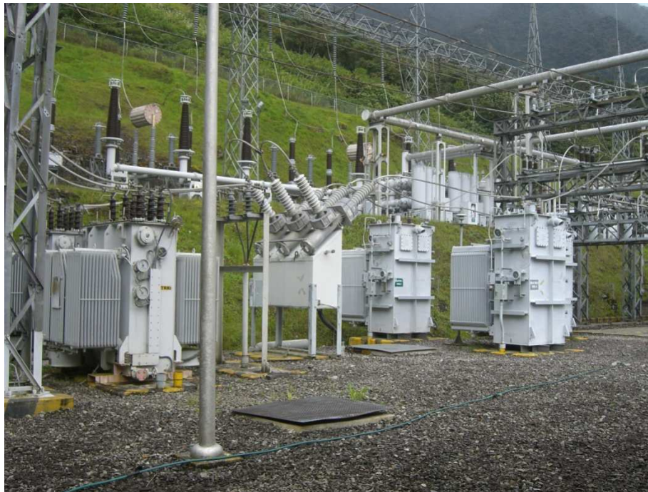
Figura 2.5: Subestación de la Central Molino.
