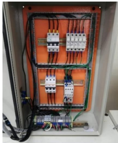
Figura 2-2: Tablero de control del módulo de generación monofásico
