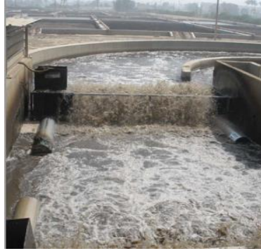
Figura 2-5: Sistema de Aireación
