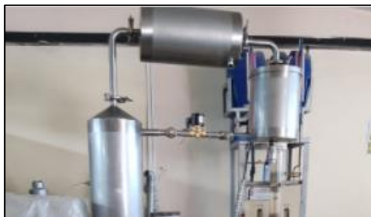
Figura 5-4. Tuberías de acero inoxidable
