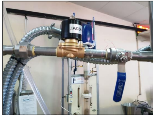
Figura 8-4. Válvula de recirculación
