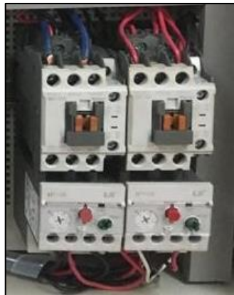
Figura 14-4. Selectores y relés térmicos
