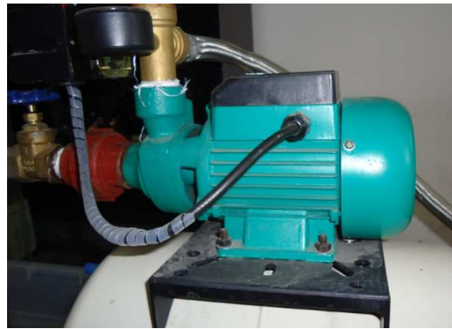
Figura 3.1: Bomba centrífuga B1
