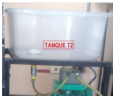
Figura 3.23: Tanque T2 instalado
