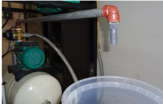
Figura 3.19: Descarga de la bomba B1
