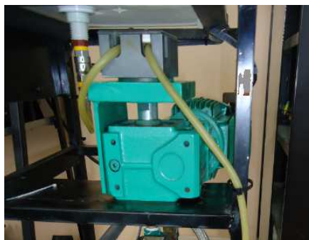
Figura 3.21: Succión de la bomba dosificadora
