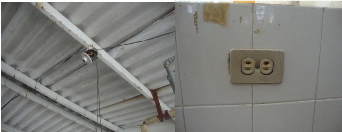
Fig. 3.10: Estado de iluminación y tomacorrientes
