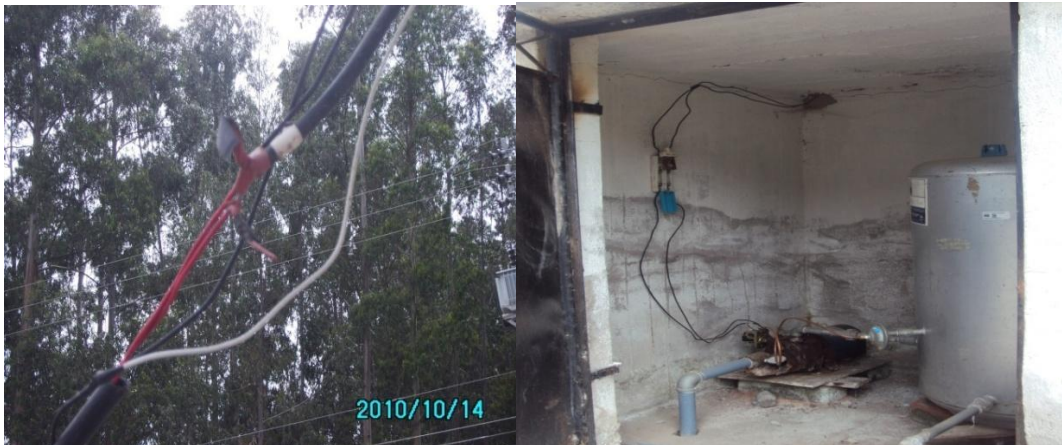
Fig. 3.7: Conexiones de bomba de
