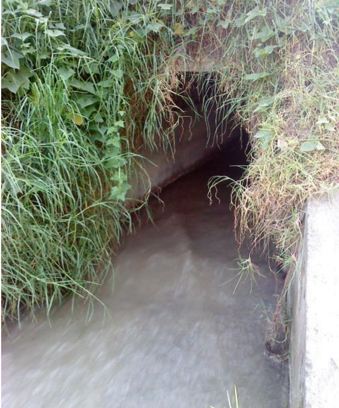
FIG. 21. Punto de medición de caudal y muestreo
