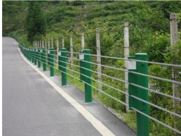
Figura 1-2. Baranda de seguridad de cable de acero
