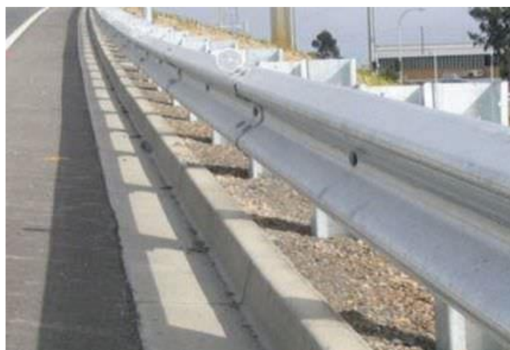
Figura 5-2. Baranda de seguridad de acero galvanizado
